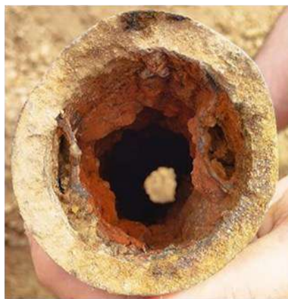
Ancienne canalisation en fonte datant de 1933.
